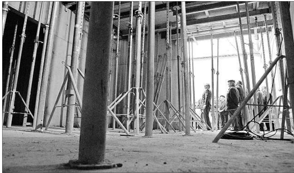
Noch beherrschen Metallstützen den Raum , in dem später das „Goldene Rössl“ stehen wird. Am 1. Mai soll alles fertig sein – vorausgesetzt, das Wetter spielt mit. – Foto: Kleiner
